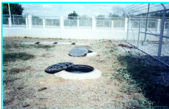
รูปที่ 6.12 แสดงบ่อพักสาย (Manhole) ในสถานีไฟฟ้า (Sub-station)
